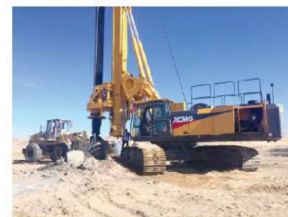
屹立戈壁滩，XR360旋挖钻机助力 京新高速公路工程建设 XR360 is working in the desert
